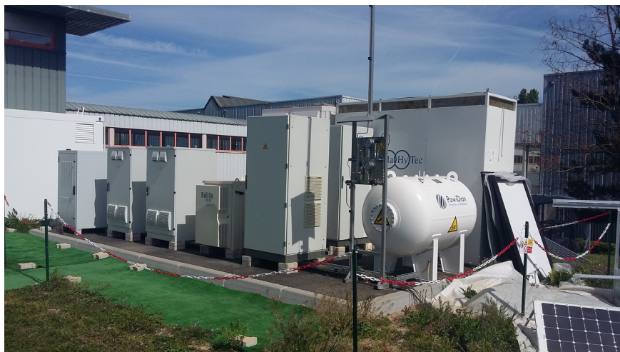
Illustration 9: Installation réservoirs, électrolyseur et piles à combustible de PowiDian.
