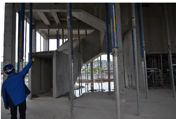
Illustration 18: Photo de la réalisation de l'escalier monumental de l'hôtel de la métropole Rouennaise
