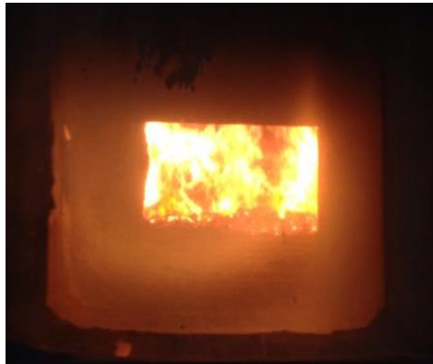
Foyer de la chaudière de 7200kW à Maromme
