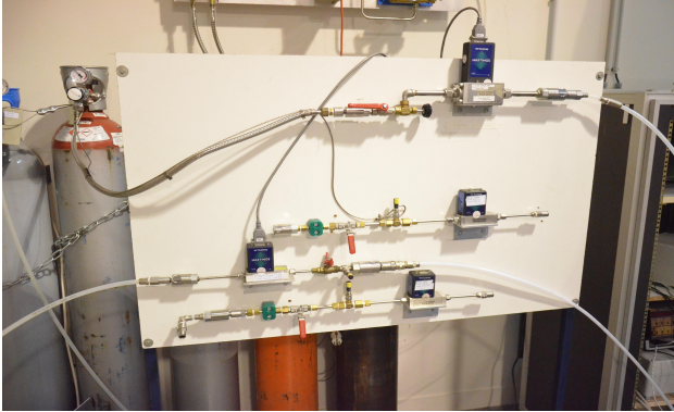
Vannes de controle des gaz
