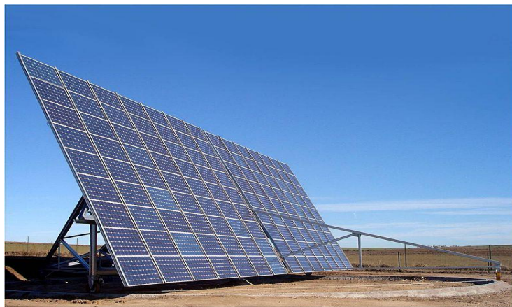
Figure 16 : Traqueur solaire en Espagne
