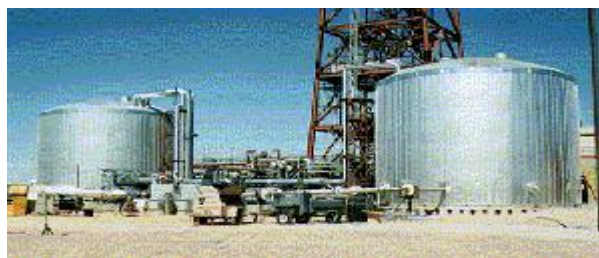
Illustration 21 : Deux cuves de sels fondus se trouvant à la centrale Solar 2 en Californie (USA)
