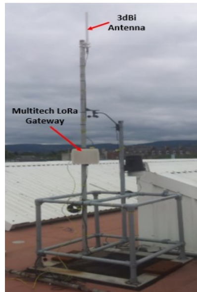
Figure 8: Image de l'installation de la passerelle LoRaWan
